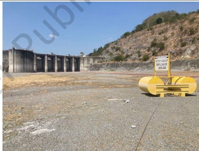
Larawan 23: Approach ng spillway na may babalang karatula
