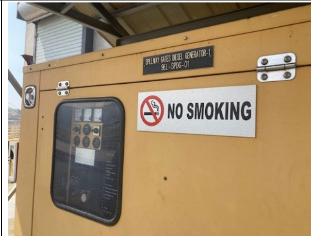
Larawan 24: Backup na diesel generator ng mga spillway gate
