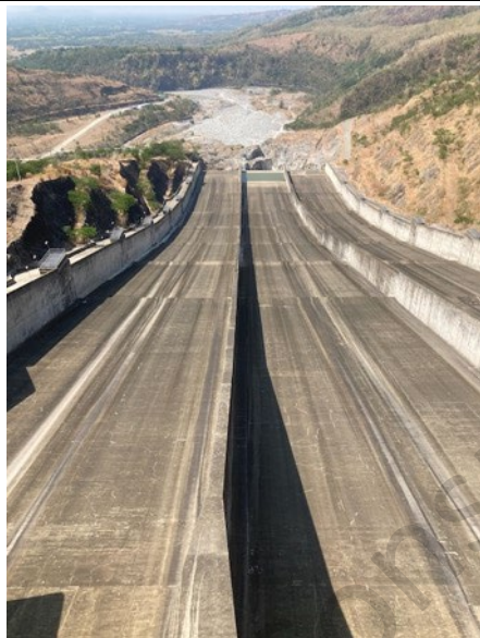
Larawan 26: Mga chute ng spillway na may aeration lips at skijump sa dulo, powerhouse sa liko ng ilog sa kaliwa, kapatagan sa abot-tanaw
